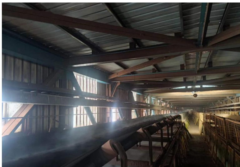
烧结前混合料 (二次混合) 位置现场图
